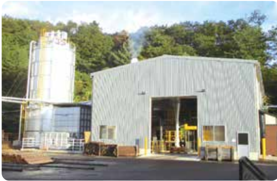
木屑焚8tボイラー
